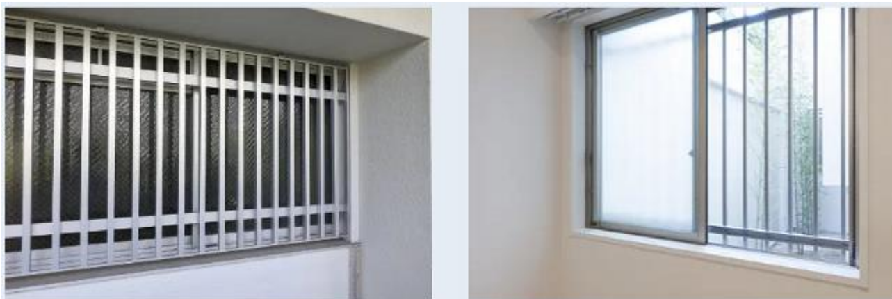
■窓サッシ改修にあわせて、アルミ面格子を新規設置し防犯性能アップ
