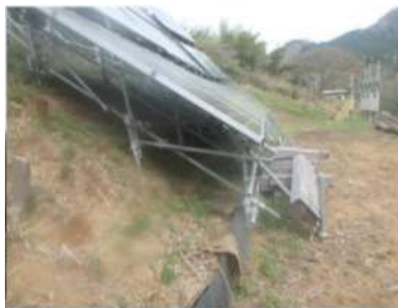
図 4-11 安全性に懸念のある施工
